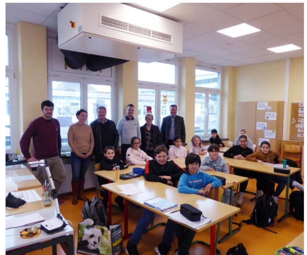
Inbetriebnahme der Lüftungsanlagen am 24.11.2022 im Beisein von Bürgermeister Michael Neher und Vertretern der Schulleitungen der Uli-Wieland-Grund- und Mittelschule Vöhringen sowie des beauftragten Planungsbüros Speiß sowie der Schüler der Klasse 5b der Uli-Wieland-Mittelschule Vöhringen mit ihrer Klassenlehrerin Gabriele Konrath.
